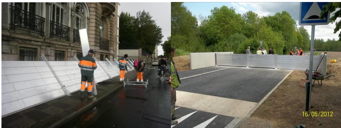
Figure 9 : Batardeaux amovibles anti crue sur voirie (Source : www.esthifrance.com )
