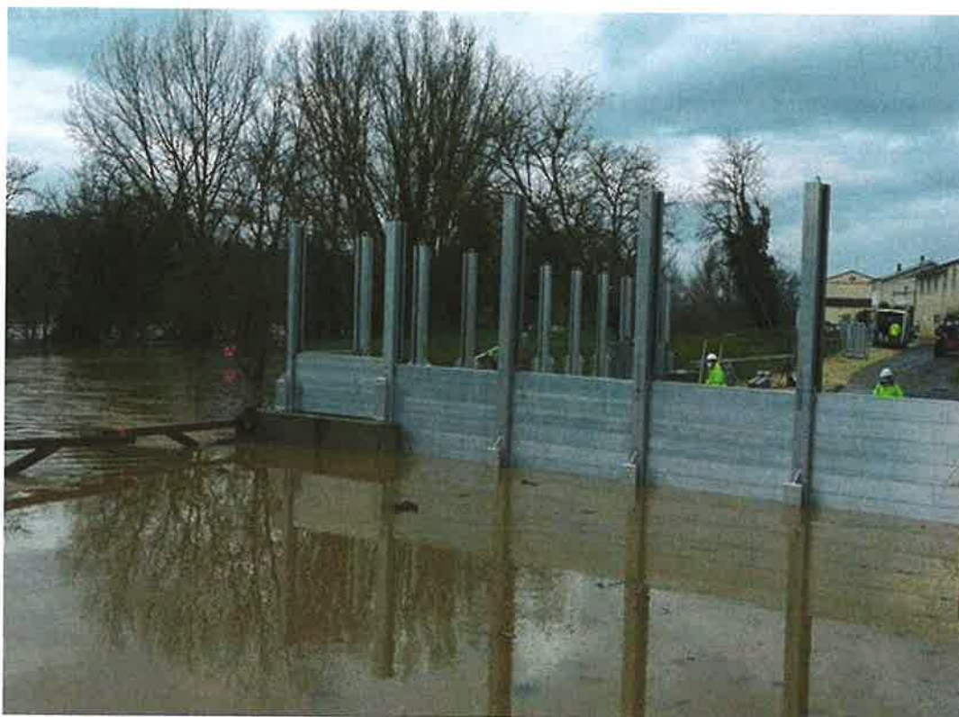
Barrières anti-inondation ESTHI en fonctionnement - © ESTHI
