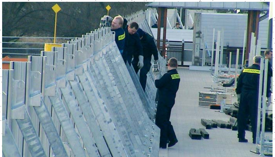
Installation du système IBS effectuée par le THW (Agence Fédérale de Secours Technique).
