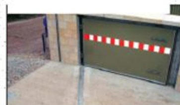
Rail encastré au sol
